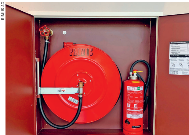
Schrank mit Wasserlöschposten und Feuerlöscher.
