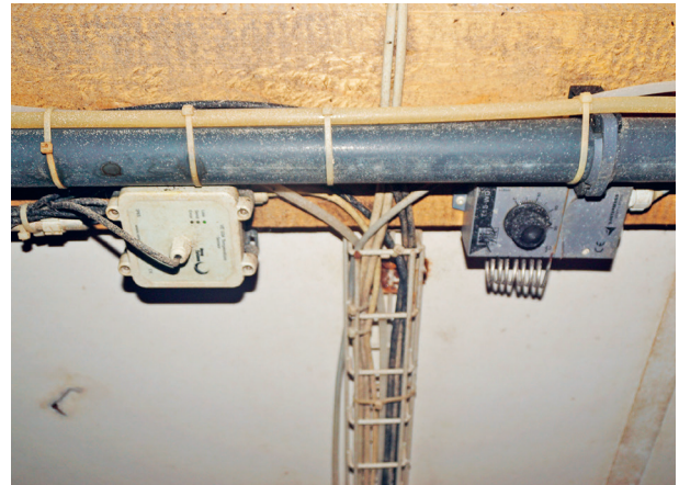
Offen verlegte Kabel sind leicht zugänglich und werden weniger von Nagern angefressen.
