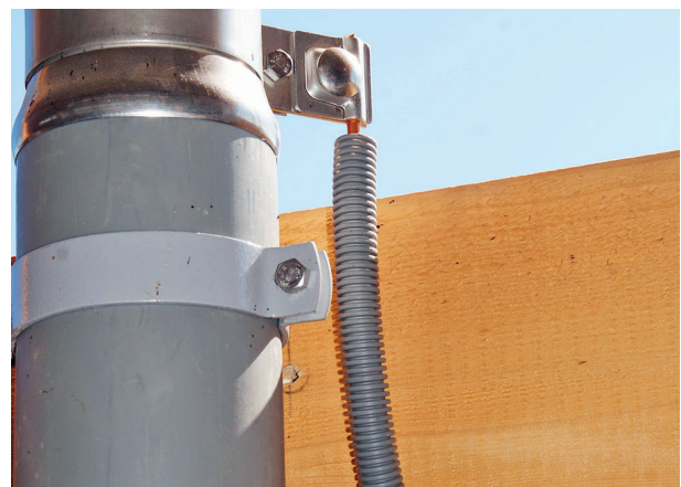
Ableitende Kupferdrähte, ummantelt mit feuerfesten Rohren.
