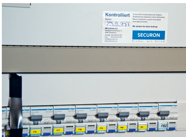
Sicherungskasten wurde von einer konzessionierten Firma kontrolliert.
