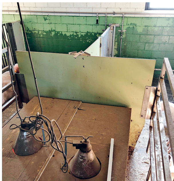
Wärmelampen sollten nicht mit Holz in Berührung kommen.
